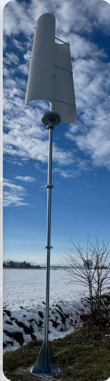
Turbina su palo a terra
