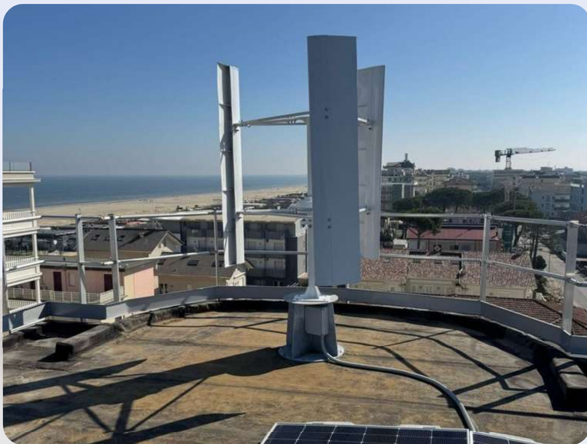
INSTALLAZIONE DI 4 TURBINE DA 3KW ABBINATE AD UN IMPIANTO FOTOVOLTICO DA 60KW AL HOTEL VILLA DEL MARE A CERVIA
