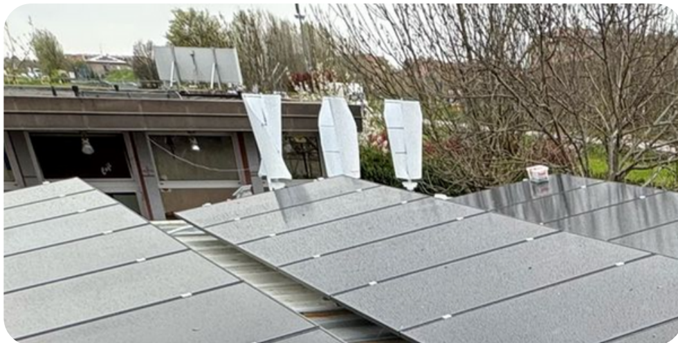
INSTALLAZIONE DI 3 TURBINE DA 2KW ABBINATE AD UN IMPIANTO FOTOVOLTICO DA 12KW IN UNA PIZZERIA A BOLOGNA
